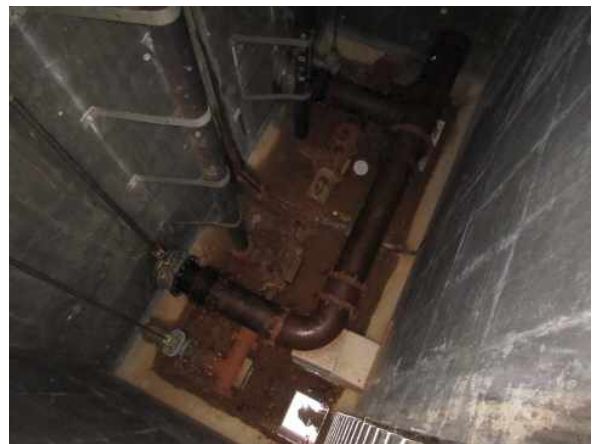
[밸브실 내부 전경]
