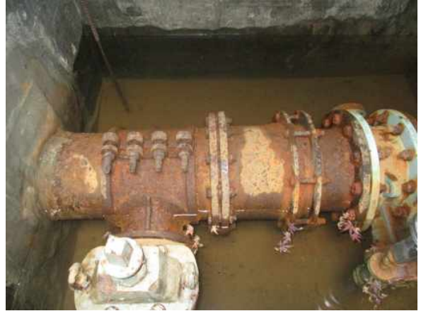
〔2호지 유입배브실 관 부식〕
