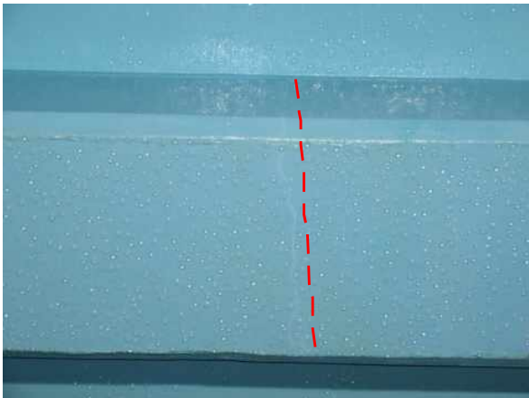
[배수지 1호지 보 : 균열]
