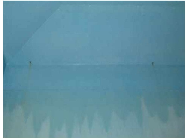
〔배수지 2호지 상부슬래브 : 녹물〕
