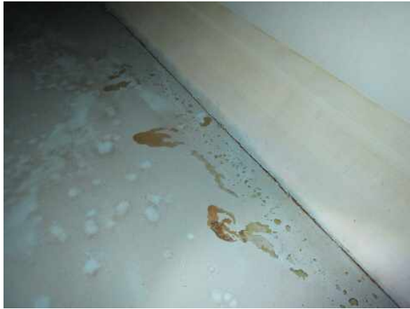
〔배수지 2호지 바닥슬래브 : 도장박리〕
