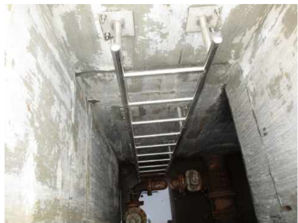
〔2호지 유입밸브실 : 사다리 상태양호〕
