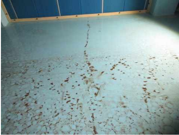
[배수지 1호지 바닥슬래브 : 균열]
