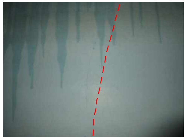
〔배수지 2호지 벽체 : 균열〕
